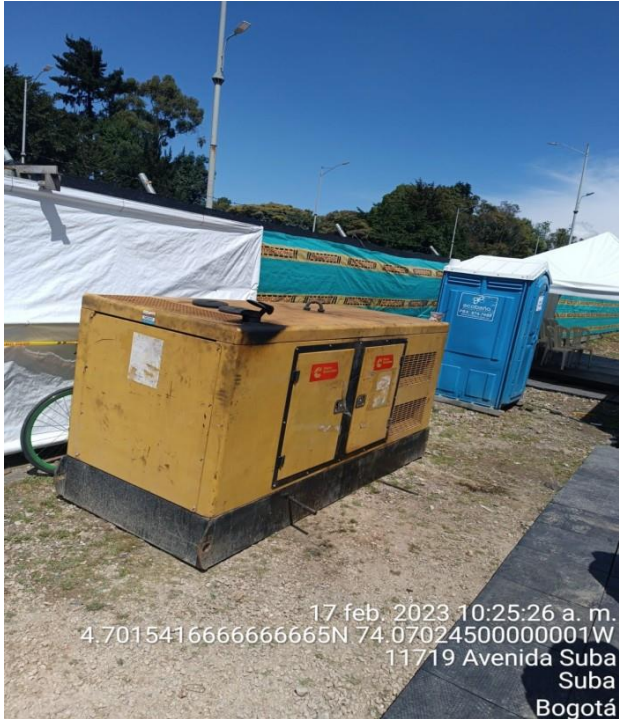
Fotografía No. 5 Planta eléctrica móvil para desarrollo del evento, sin debida protección al suelo.
