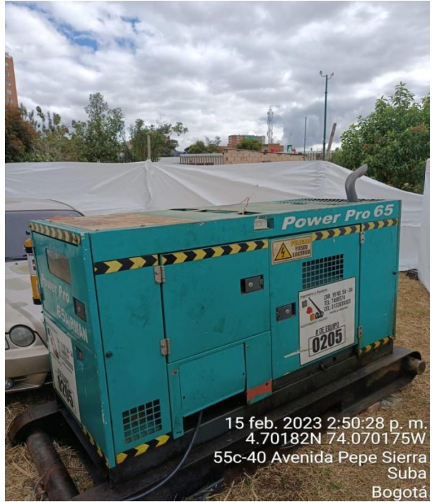
Fotografía No. 6 Planta eléctrica móvil para desarrollo del evento, sin debida protección al suelo.
